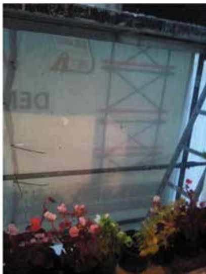
Slika 15. Zagrađeni prozor na istočnom zidu Dioklecijanove palače, skela omogućava i pristup tuđoj imovini. © Matko Bonačić, 2024.
